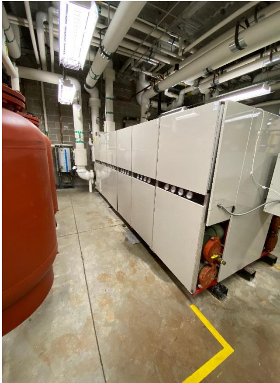
Fig. 13: Existing HP skid.
